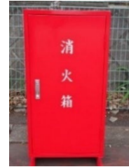
初期消火箱（固定式）
